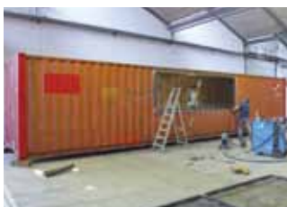
Remise en état d'un conteneur de 12 m 2 de long qui fera office de restaurant en montagne
